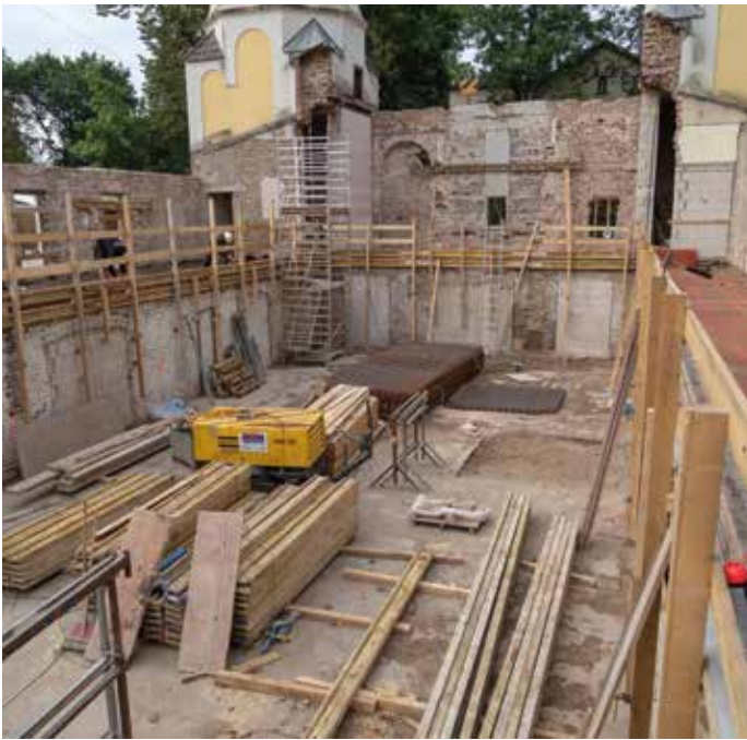
Abb. 86: Südamerikahaus nach Beendigung der Abbrucharbeiten. The South American House after completion of the demolition work.
